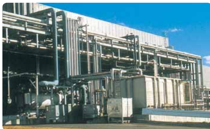
▶ 生産施設 配管設備
