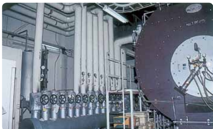
▶ ボイラー設備
