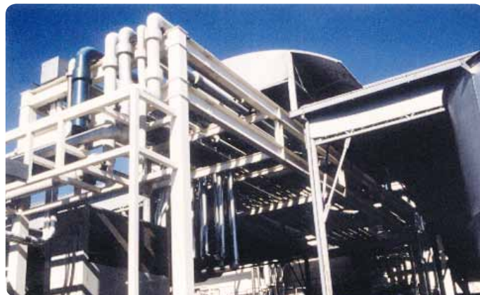
▶ ユーティリティ設備
