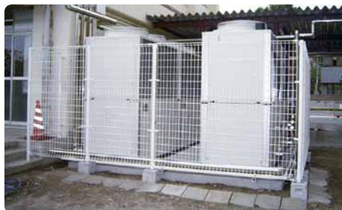
▶ ガス空調システム
