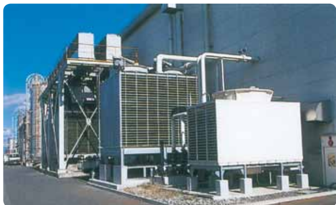
▶ 生産用冷却水設備
