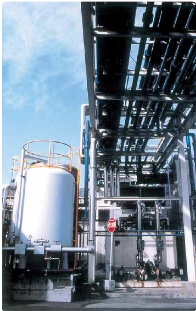
▶ ユーティリティ設備
